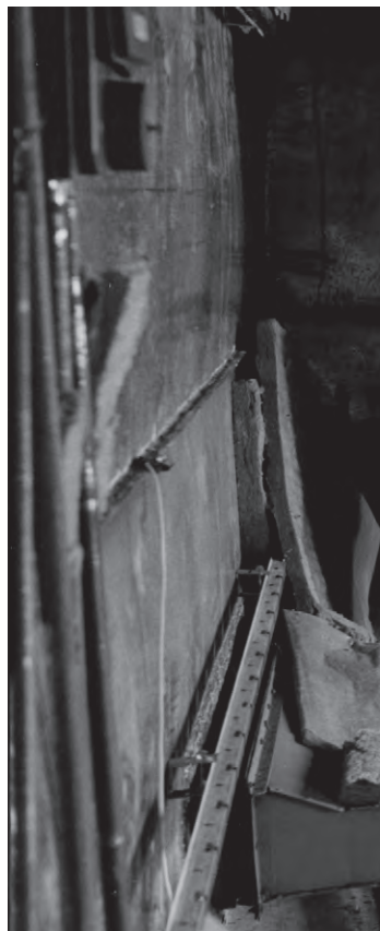
Zoufalý stav koleje byl vidět na každém kroku
